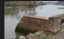
11.津波で破壊された3基のレンガ橋台の内、2基が流失、残った1基も損壊した（平成23（2011）年6月撮影）
