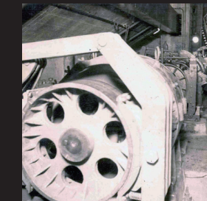
橋脚内可動機械設備
