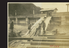
8.堤体左岸側に設置された コンベアでの木材運搬作業。 現在は廃止
